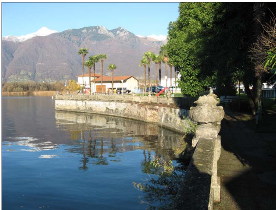
Fig. 5.25 Tratto di muro a lago accessibile ma da cui non è possibile avere un contatto diretto con il lago.
